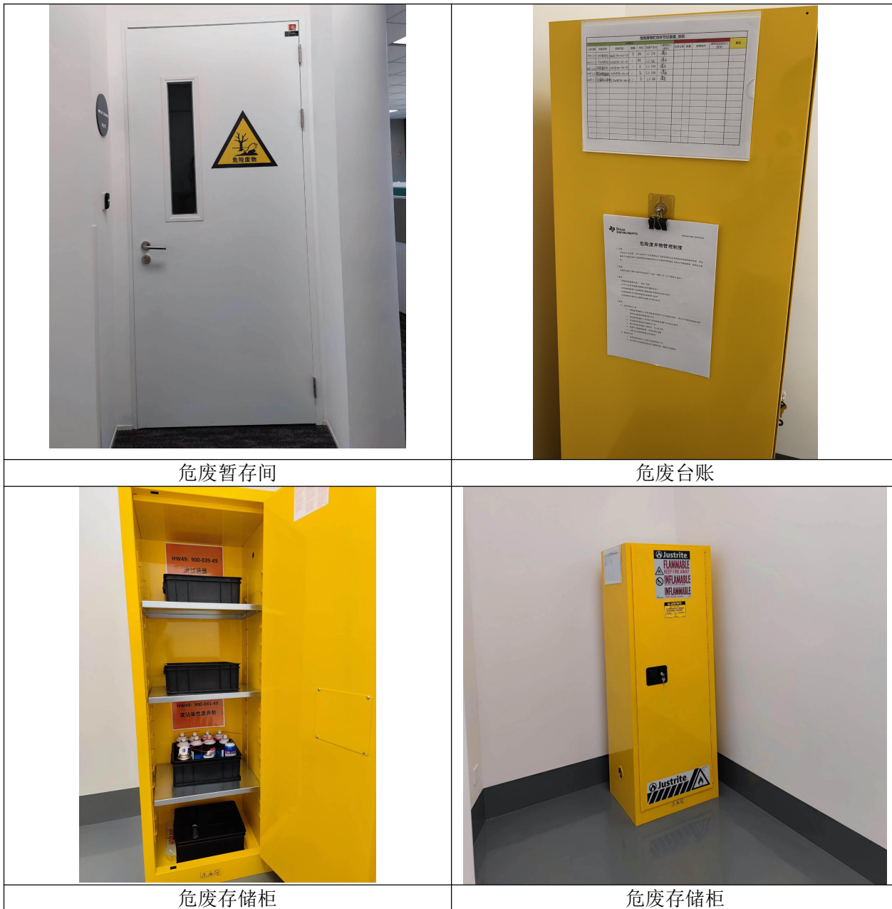
图3-2 危废暂存间现场照片
